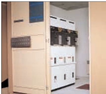
Подстанция, полностью смонтированная на заводе
